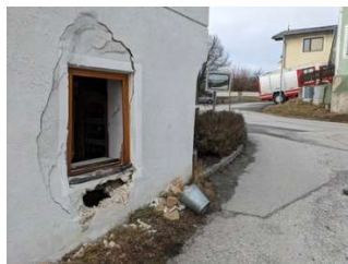
02.02.2024 – Gföhl - LKW gegen Hausmauer
